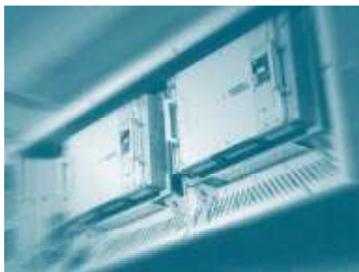
La combinación de los motores de tecnología asíncrona trifásica con los sistemas de control informático reduce el consumo energético, minimiza el coste de mantenimiento e incrementa la seguridad de los trenes
